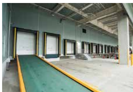
▲高床式プラットホーム、ドックシェルター（27基）
